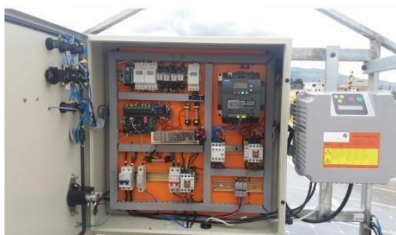
Figura 13. Tablero de control
