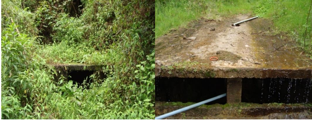
Figura 2. Cámara de captación de vertientes de Paylahuaico
