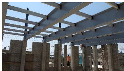
Fuente: de Heredia (2004) Figura 10: Estructura de soporte
